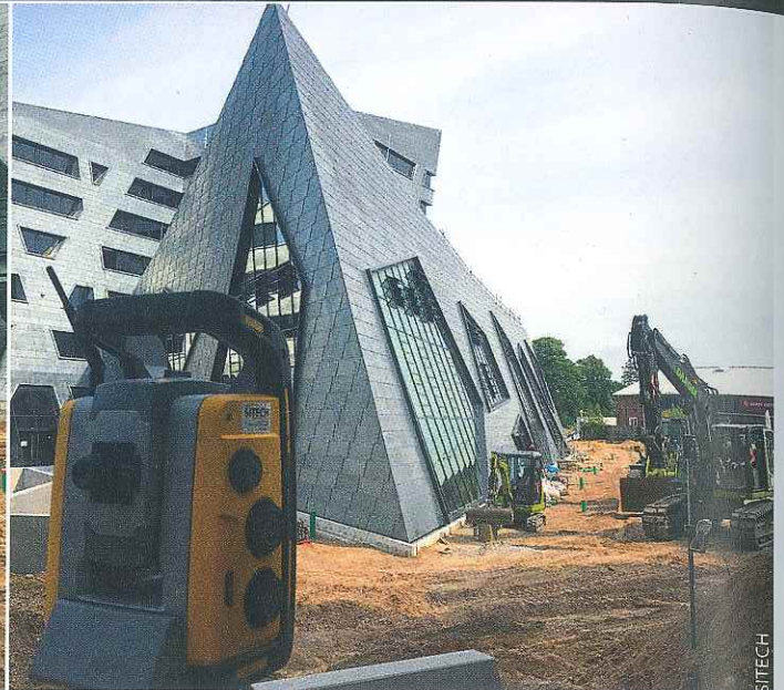
Aufgrund der perfekten Systemintegration erweist sich der Einsatz der Trimble Maschinensteuerungssysteme als vorteilhaft und kostensparend.
